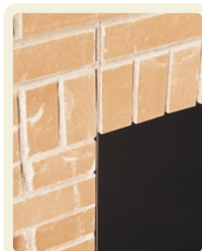
FILO TESO IN CORRISPONDENZA DELLA SPALLETTA DI UNA FINESTRA.
